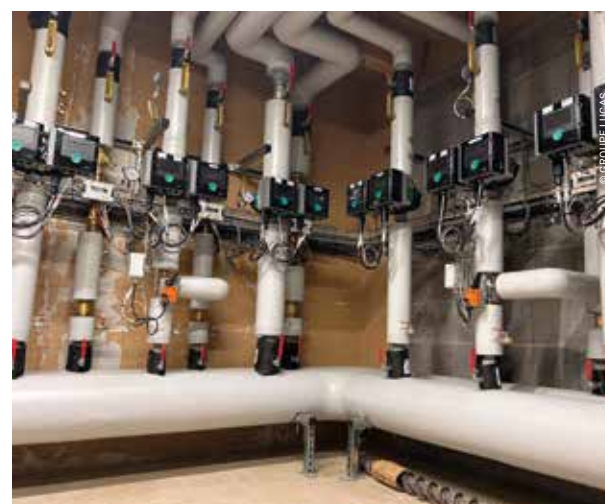
CHAUFFERIE BOIS - LASSAY LES CHATEAUX
